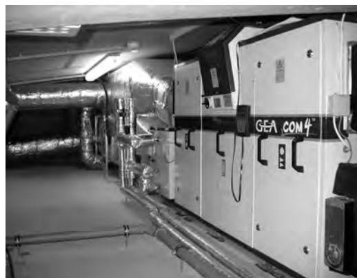
Bild 17. Lüftungszentrale für ein Gebäude mit ca. 1500 m² Nutzfläche
