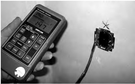
Bild 13. Charakteristische Luftundichtheit an einer Steckdose in der Außenwand bzw. mit Leerrohrverbindung in den Außen- oder unbeheizten Bereich
