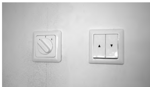
Bild 29. Einfache Lüftungsregelung mit Dreistufenschalter, direkt daneben die Verschattungsregelung
