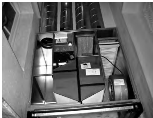
Bild 16. Blick in ein Zentralgerät einer Zu-/Abluftanlage mit Wärmerückgewinnung für ein Einfamilienhaus
