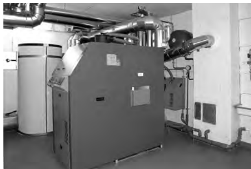
Bild 30. Pelletskessel in der Technikzentrale
