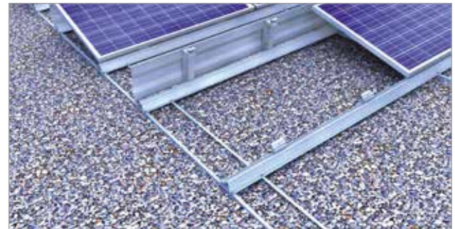
Kiesdach: Süd-System I mit Kies als Ballast
