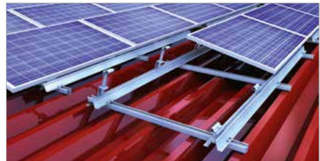
Klemmsystem: Südausrichtung auf Ost-West-Dach
