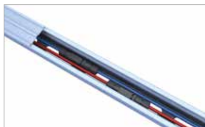
C-Schiene als Kabelkanal
